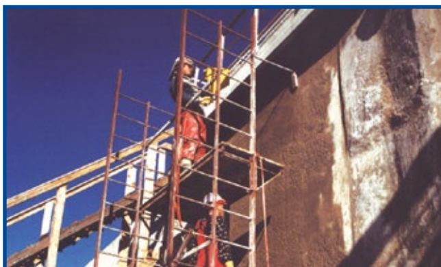
Έργο: Rigas Udens Βιολογικός Καθαρισμός
